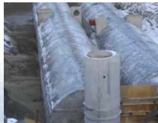
Bassin de rétention des eaux pluviales. Composantes certifiées.
