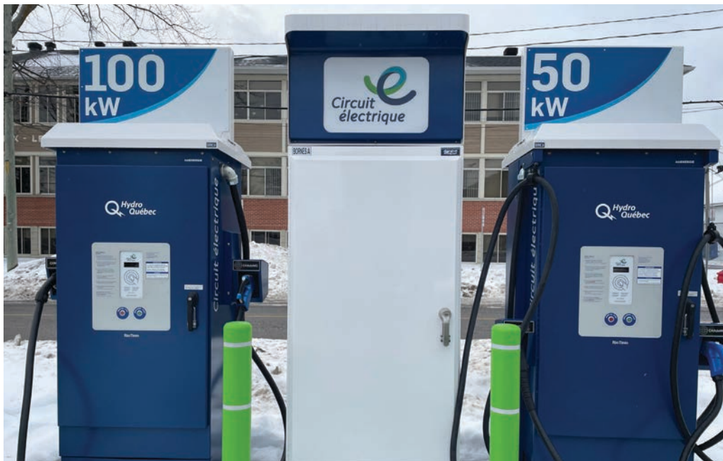
Bornes électriques à la ville de Bois-des-Fillion
