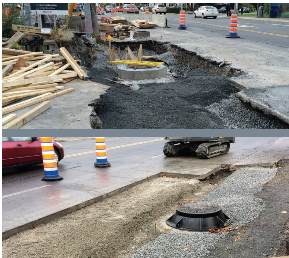
Exemple d'avis de non-conformité, avant et après la correction.
