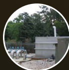
Puits de pompage et réservoirs de rétention d'égouts
